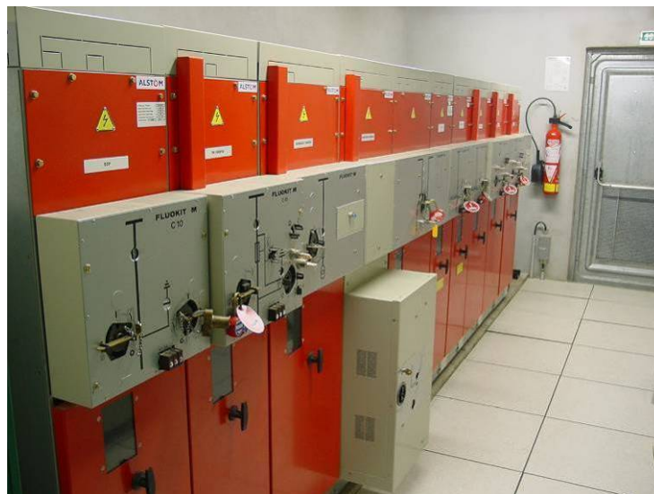
Intérieur d'un poste de livraison
